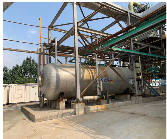
碱液储罐及围堰
