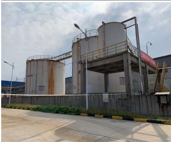
硫酸储罐及围堰
